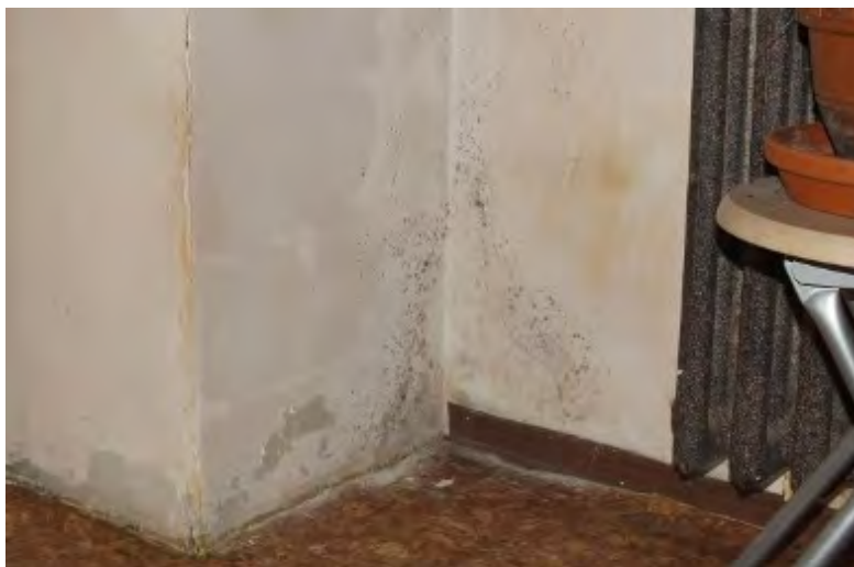
Zatopený objekt po opadu vody s růstem plísní na povrchu provlhlého zdiva
