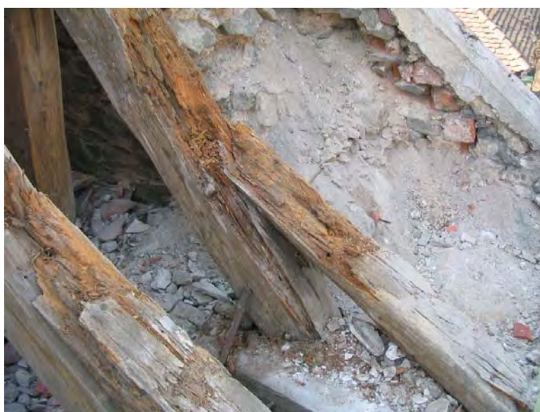
Poškozená krovová konstrukce barokního kostela
