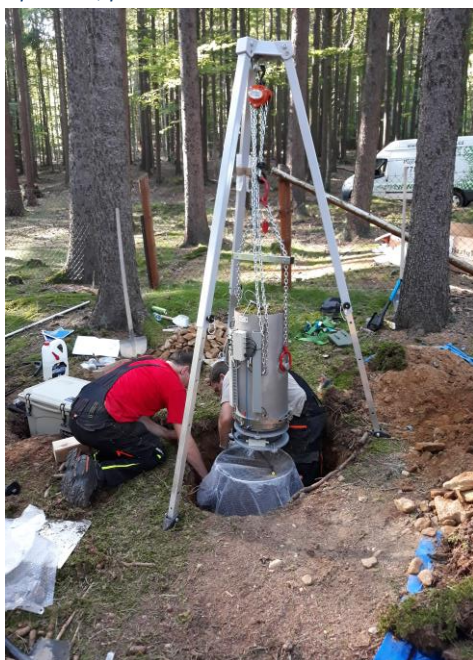
Instalace půdního lyzimetru měřícího výpar z povrchu, povodí Liz
