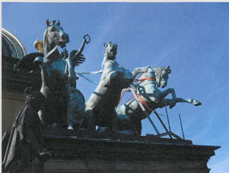
Zatěžovací zkouška západní trigy bronzových soch koní s kočářem na pylonech střechy Národního divadla v Praze. Na obrázku je zobrazeno zavěšení sochy koně na podpůrné konstrukci umožňující jeho nadzvednutí.
