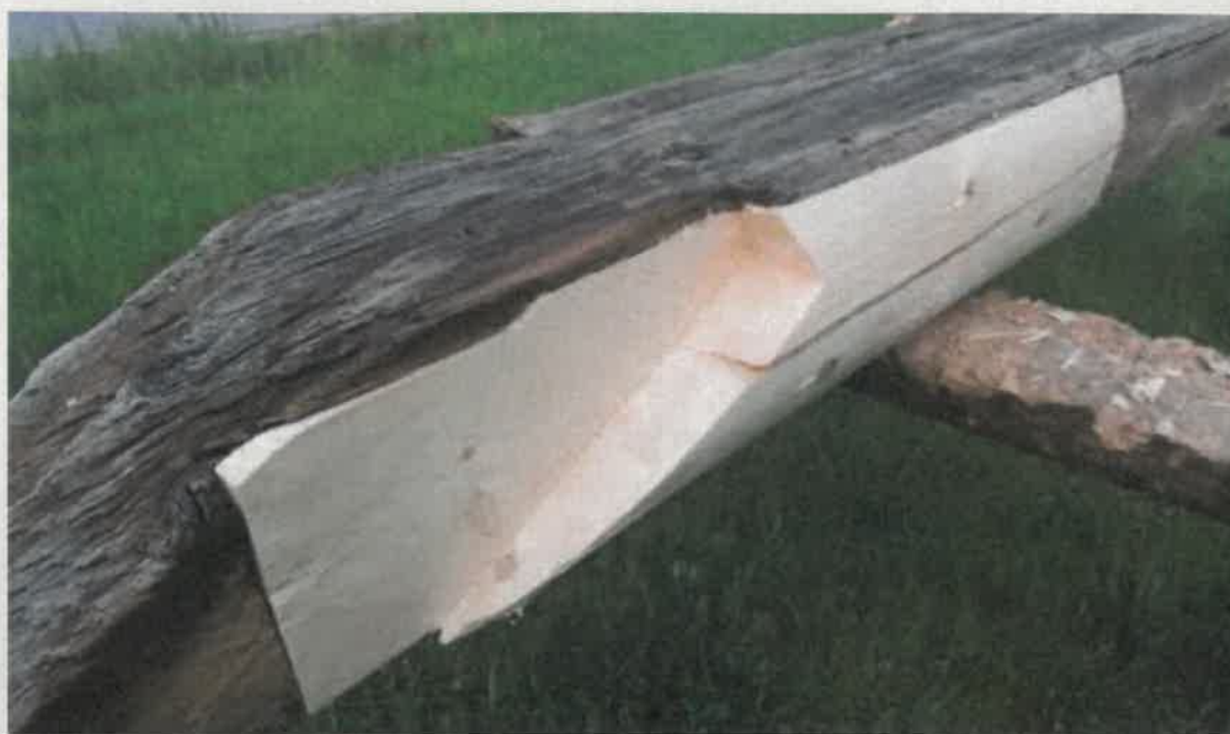
Výplň poškozeného prvku. Poškozená část může být opravena v případě historické památky touto metodou.
