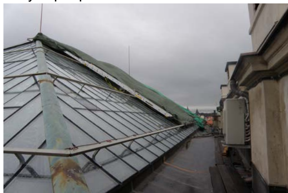
Oprava světlíku po výbuchu plynu
