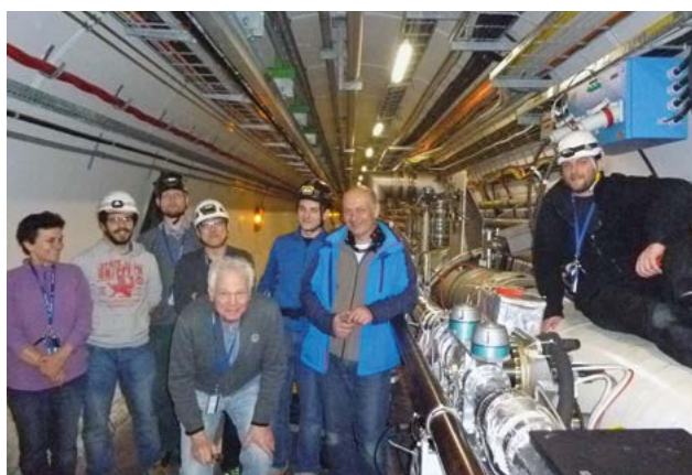
■ Obr. 1 První rameno detektoru dopředných protonů AFP nainstalované v tunelu LHC. Zodpovědným za celou instalaci detektoru byl náš pracovník P. Šícho (druhý zprava).
