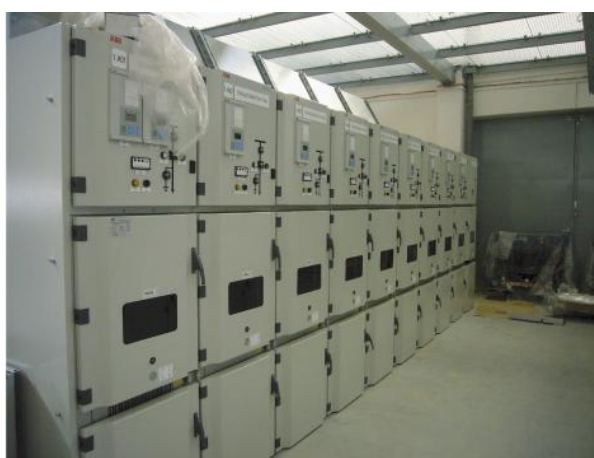
Obr. 8: Vysokonapěťová oblast napájení – 6kV rozvodna.
