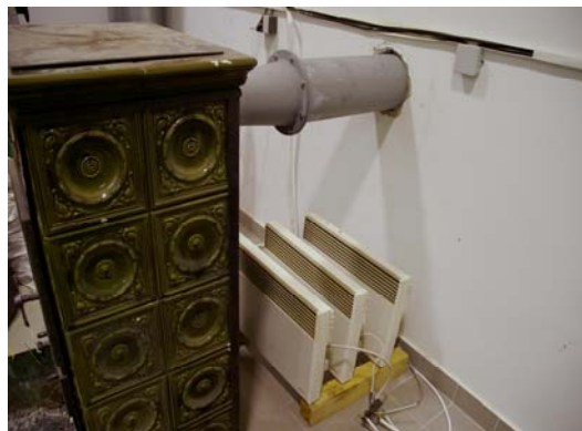
Obr. 7: Průchod kouřovodu zdí směrem k filtru
