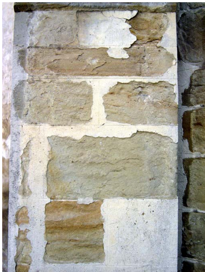
Příklad poškozeného zdiva degradací materiálu
