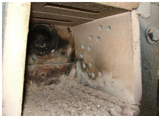
Obr. 11.2. Detail hořáku kotle Verner A25
